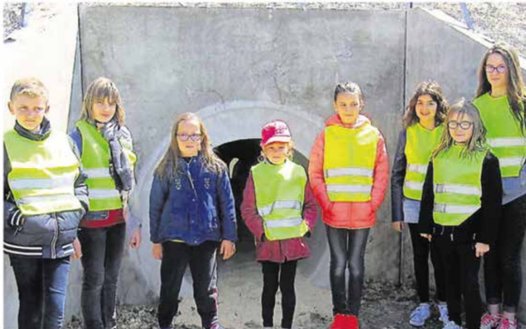
Le Conseil municipal d'enfants s'est intéressé à l'écoduc - sorte de corridor - aménagé sous l'autoroute A11, à hauteur de leur commune, afin que les animaux de petite taille puissent la traverser sans aucun risque.
